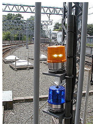
設置例:(電車接近時 黄点灯)
